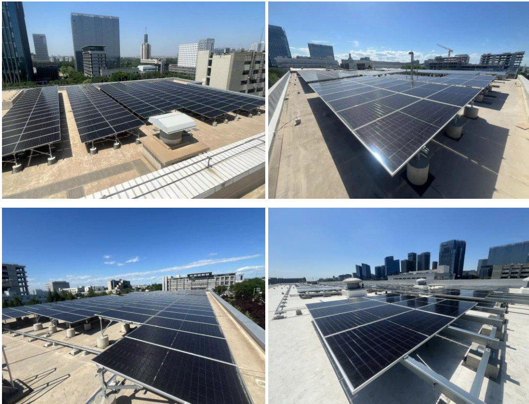
图 49 屋顶分布式光伏发电设施
